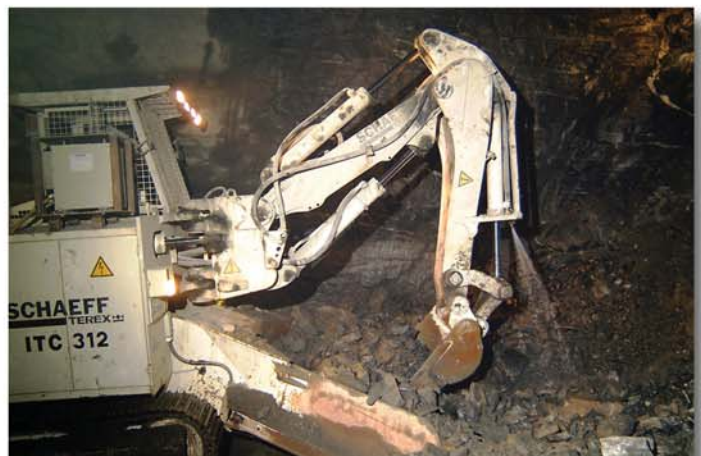
Die Schuttermaschine voll im Einsatz, 3-5 m 3 Haufwerk werden pro Minute auf LKW geladen
