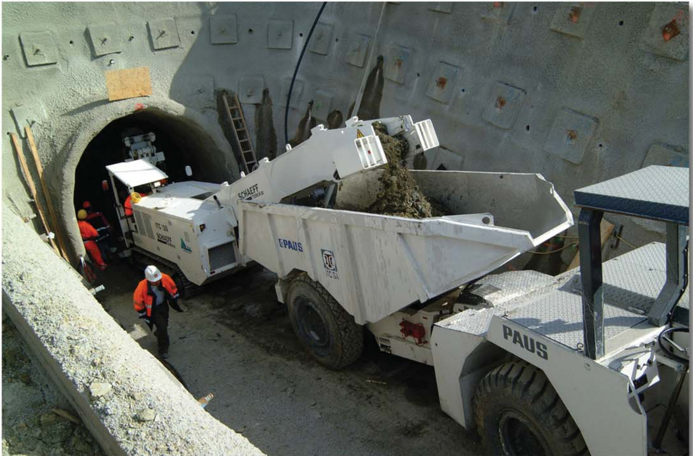
Die Tunnelvortriebsmaschine Schaeff Typ ITC 120 beim Beladen des Muldenkippers Paus model ITC 8000
