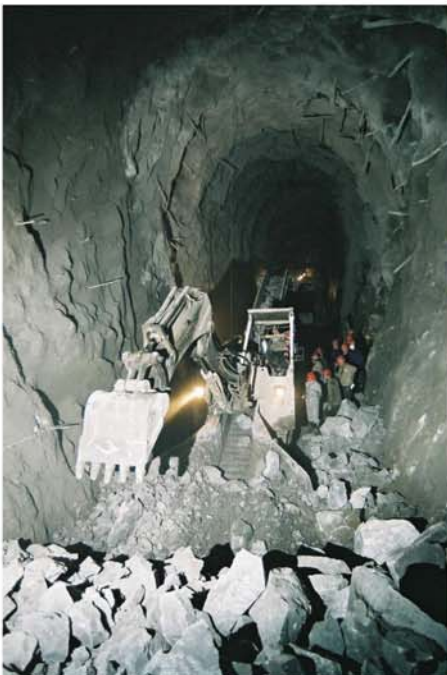
Abbildung 11: Schüttern im Haupttunnel
