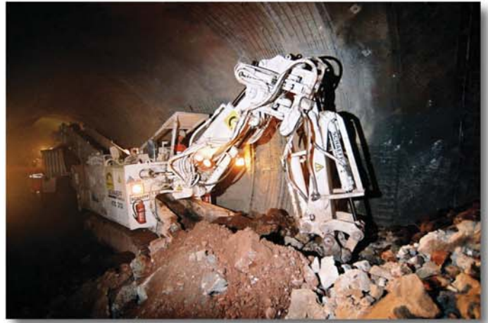
Bild 3: ITC 312 beim Laden des gelösten Materials
