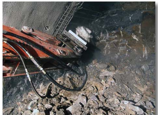
Linker Ulmenstollen: der Schaeff-Tunnelbagger TE 200 beim Profilieren der Kalotte mit der Anbaufräse
